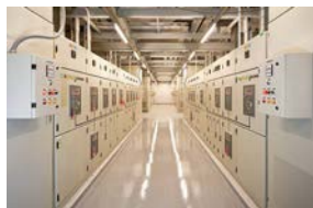
機械室・電気室
